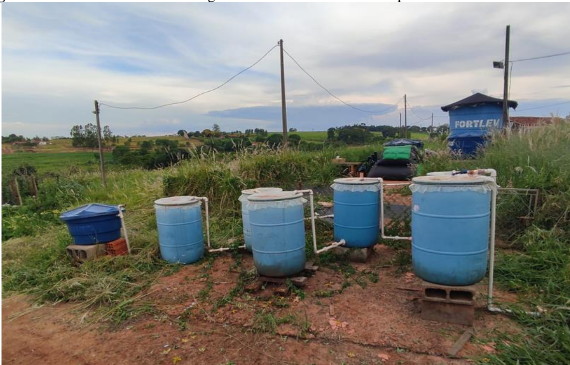
Figura 2. Sistema de tratamento de água residuária instalado no Campus da FCA
