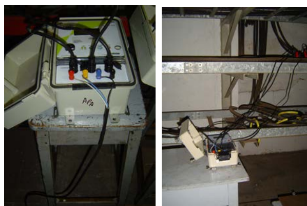
Figura 2: Analisador portátil Saga 4500 ligado em rede trifásica junto à entrada de energia na Usina USB.
