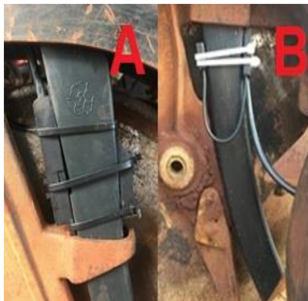
Figura 1. A – Sensor com fio instalado no tubo condutor. B – Sensor sem fio instalado no tubo condutor.
