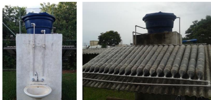
Figura 1 - Aquecedor solar de baixo custo instalado na Faculdade de Ciências e Engenharia, FCE/UNESP, Campus de Tupã.
