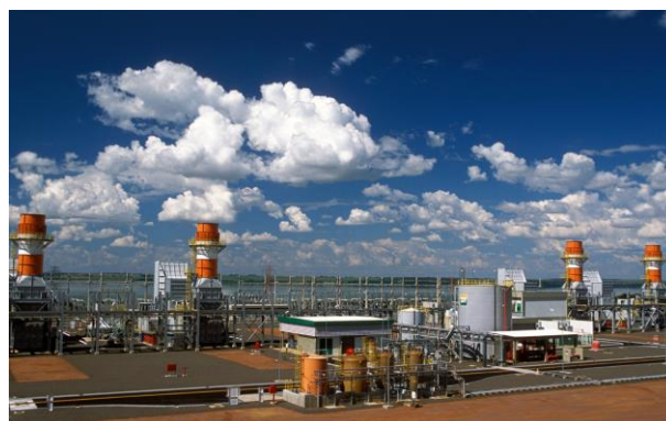
Figura 6 - Usina Termelétrica Luiz Carlos Prestes (Três lagoas/MS). Fonte: Portal 3lagoas (2017)
