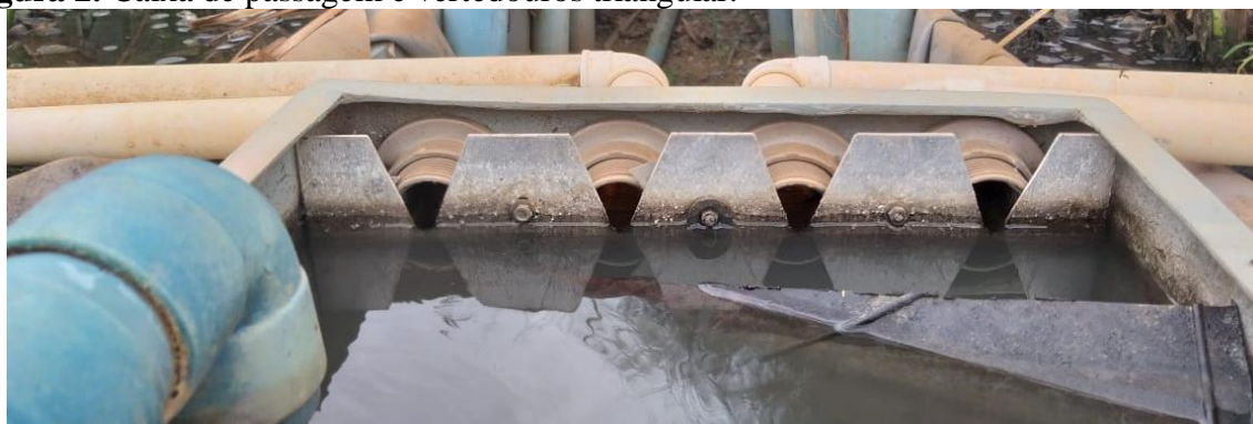
Figura 2. Caixa de passagem e vertedouros triangular.
