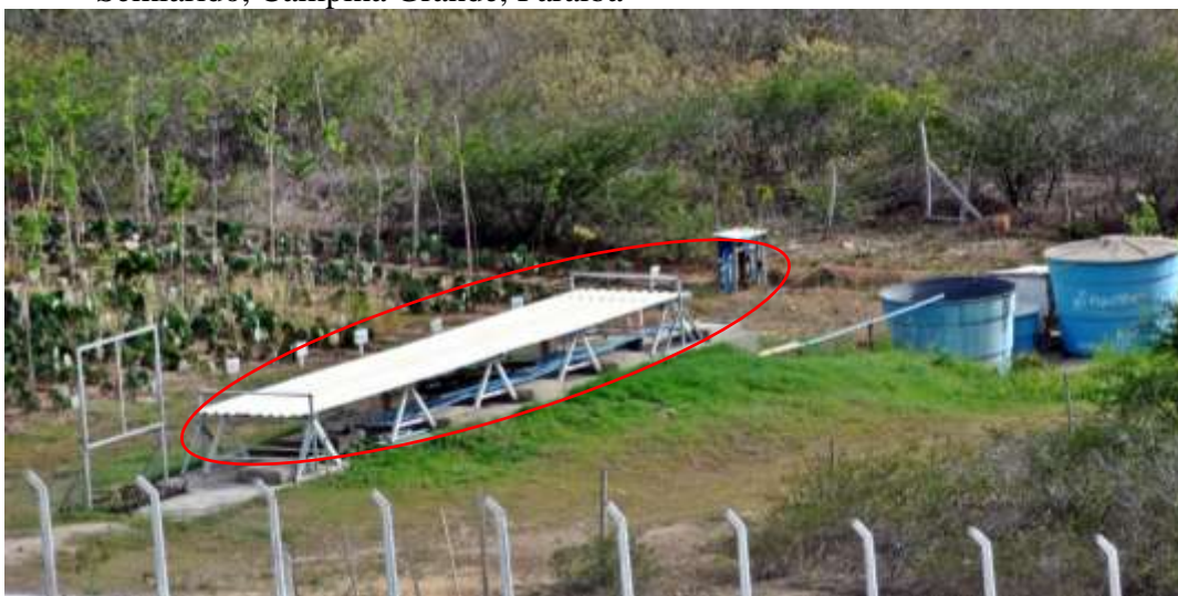
Figura 1. Estação de tratamento de esgoto doméstico da sede do Instituto Nacional do Semiárido, Campina Grande, Paraíba
